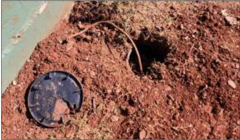
Furto dos cabos impede funcionamento do sistema de iluminação
