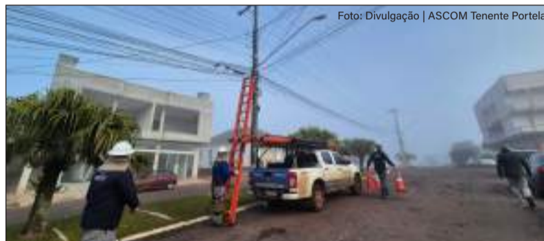
Retirada dos materiais sem utilização contribuirá para reduzir a poluição visual
