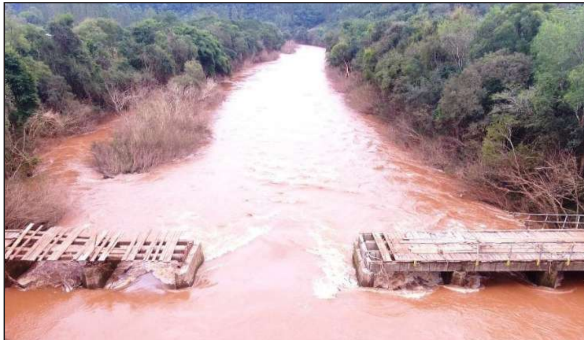
Parte de ponte entre Três Passos e Tenente Portela foi levada pelas águas
