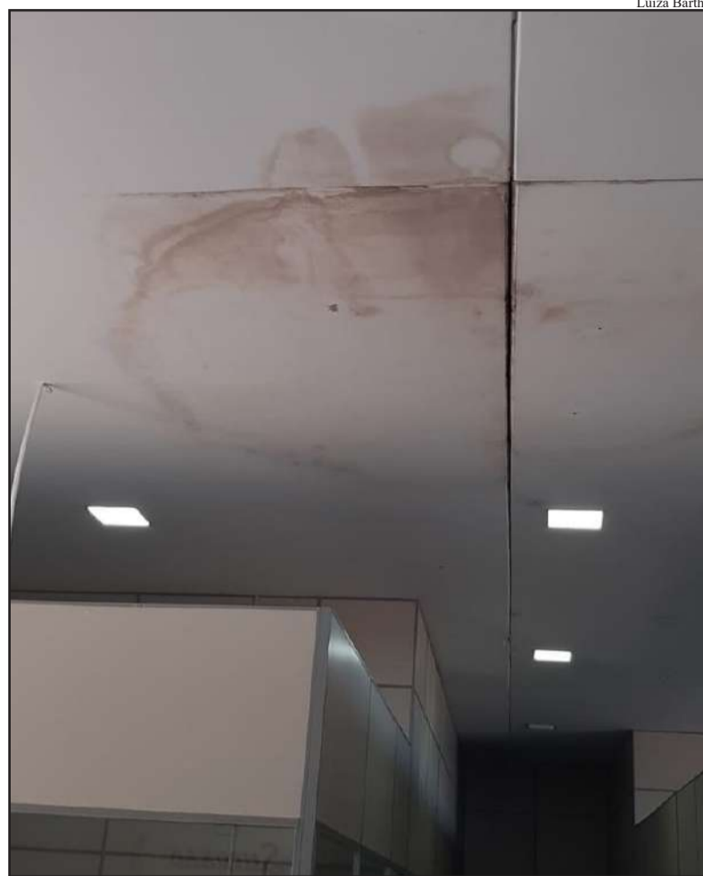
Fotos retirada por vereadora mostram sinais de infiltração de água no local
