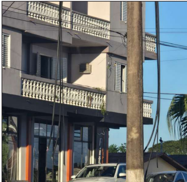
Em vários pontos da cidade existem cabos pendurados em virtude da ação dos furtadores
