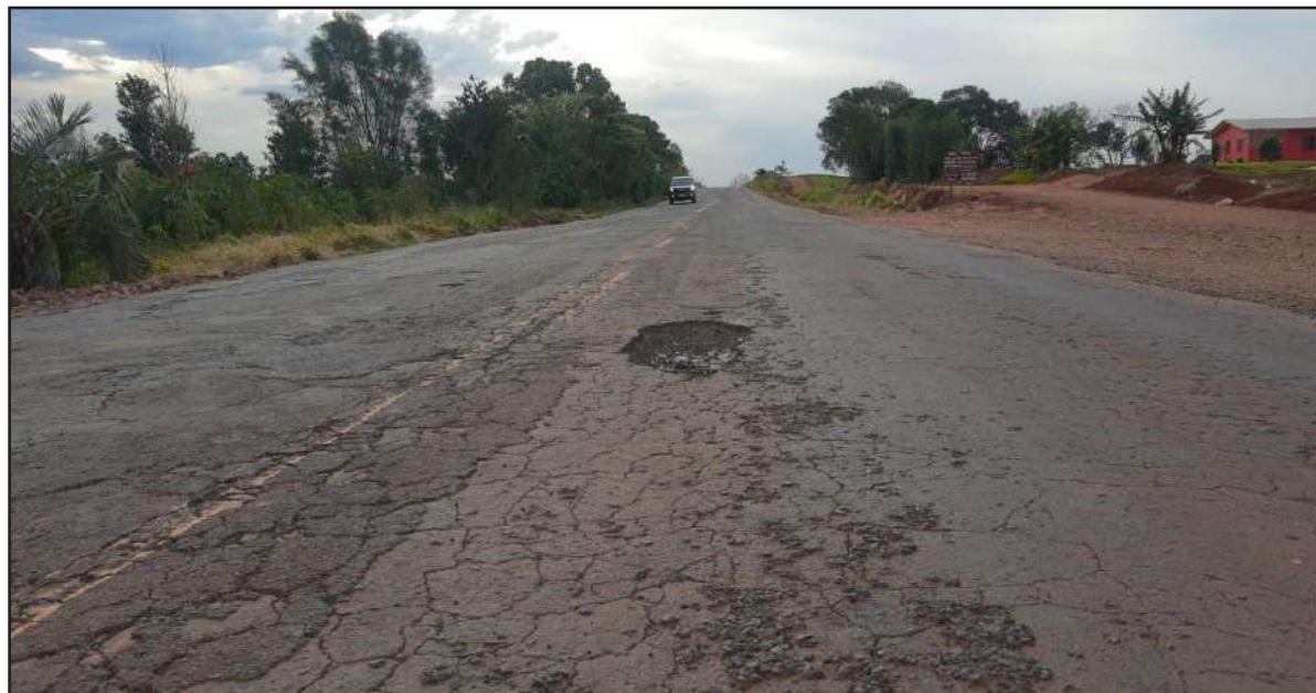
Buracos atrapalham o tráfego de veículos no trecho entre Tenente Portela a Miraguaí
