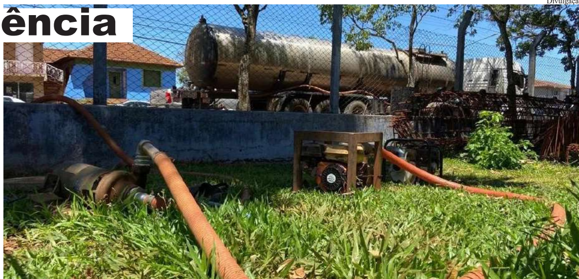
Caminhões estão trazendo água para o reservatório da Corsan em Tenente Portela
